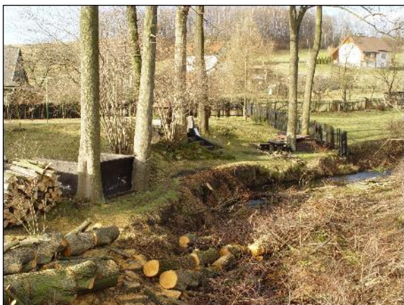
Obr. 1: Před opevněním břehu potoka 2004 (foto P. Chytil)
