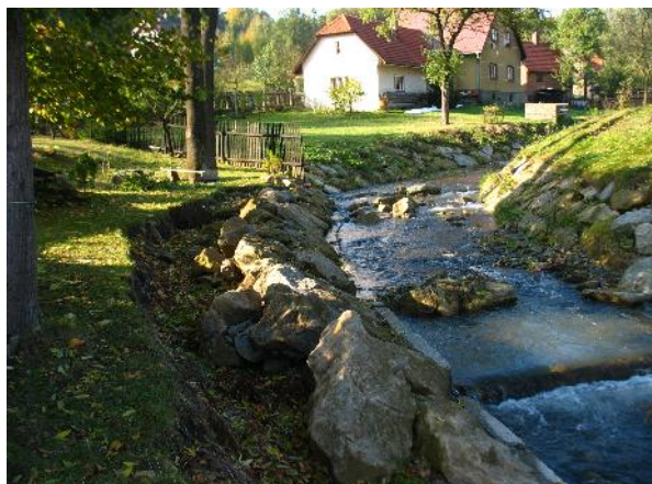
Obr. 2: Po opevnění břehu a srovnání koryta byla r. zemina vyplavena následnou povodní (foto M. Popelářová, 21.10. 2009)
